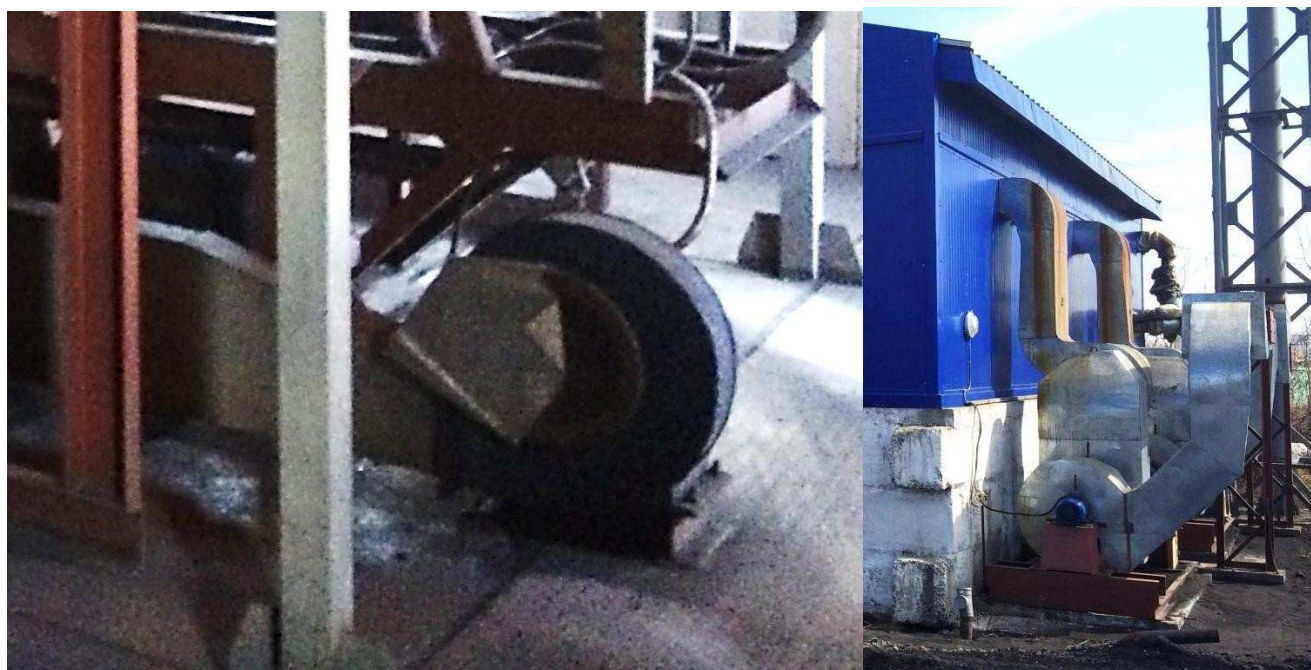
Рисунок 1.22 – Тягодутьевое оборудование котельной РТП
