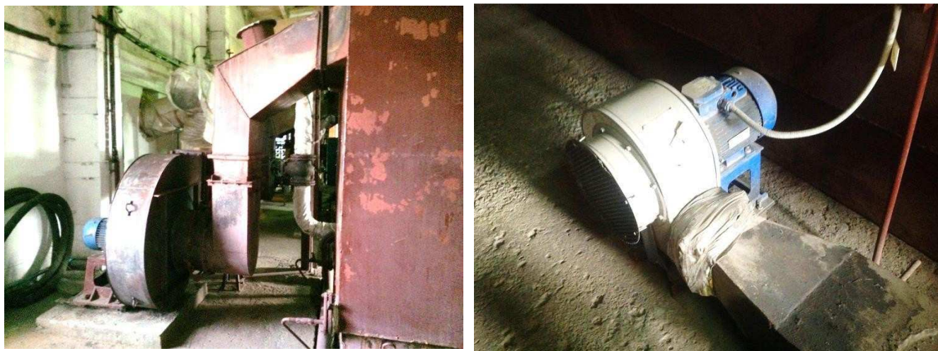
Рисунок 1.15 – Тягодутьевое оборудование котельной Н. Бровина
