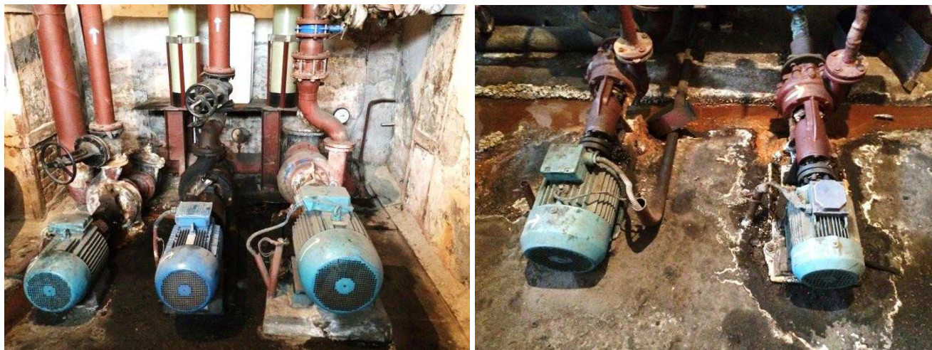
Рисунок 1.48 – Насосное оборудование котельной Ростелеком
