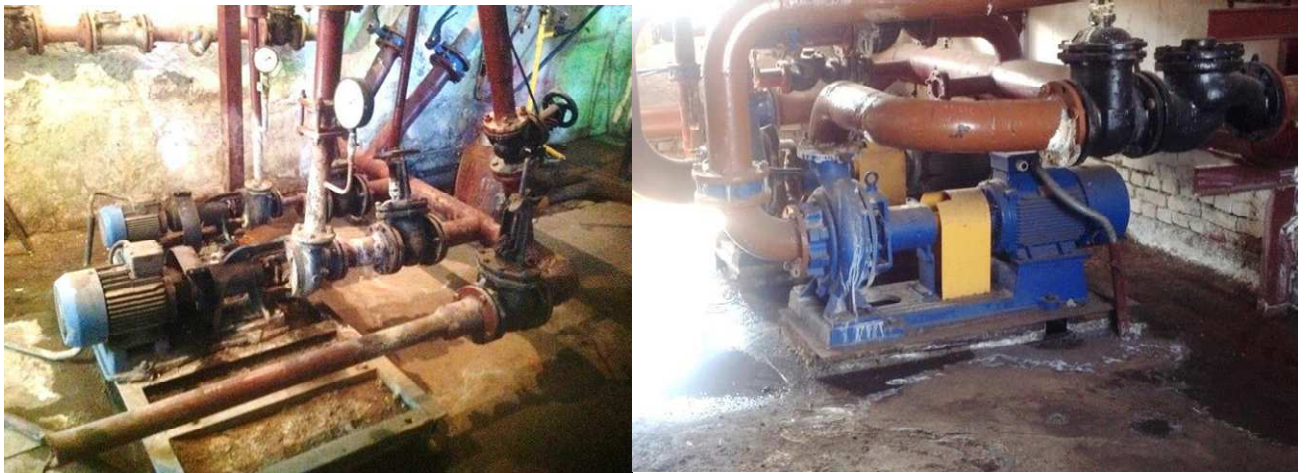
Рисунок 1.11 – Насосное оборудование котельной Н. Бровина
