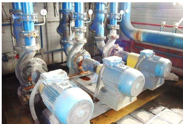
Рисунок 1.25 – Сетевые насосы котельной Коченевская
