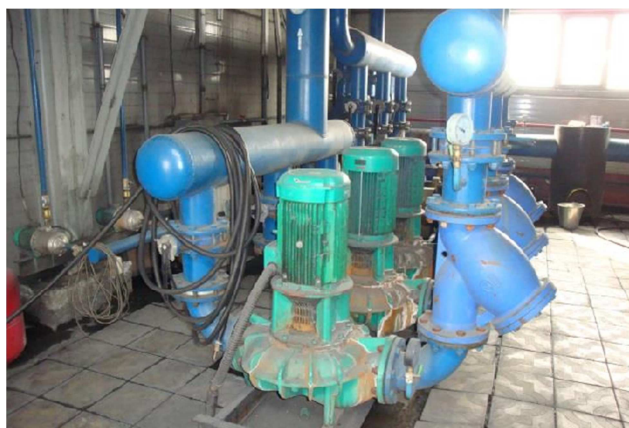
Рисунок 1.26 – Насосы котлового контура котельной Коченевская
