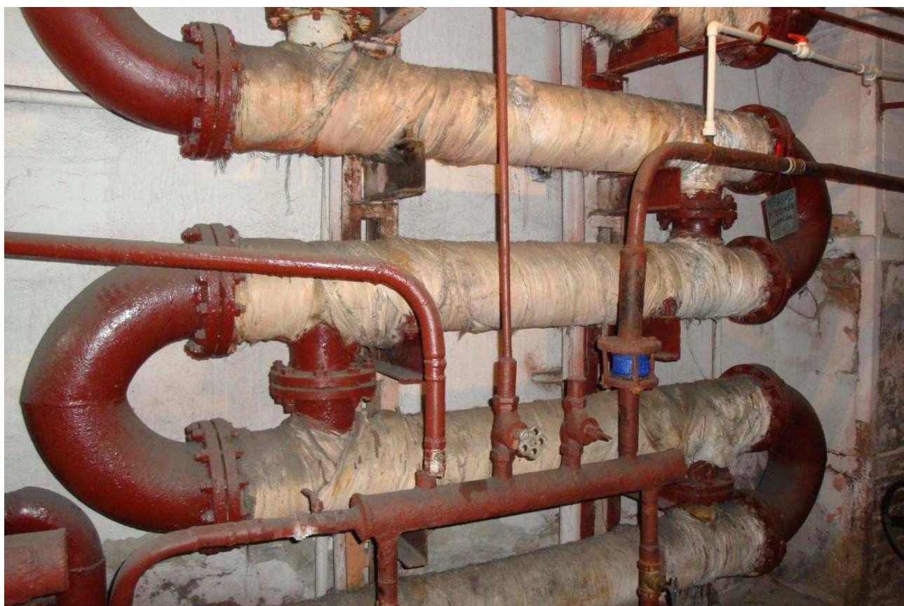
Рисунок 1.49 – Кожухотрубный теплообменник котельной Ростелеком
