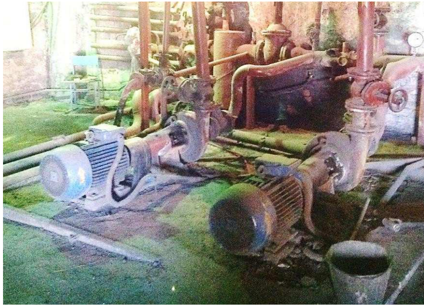
Рисунок 1.34 – Насосное оборудование котельной школы №13
