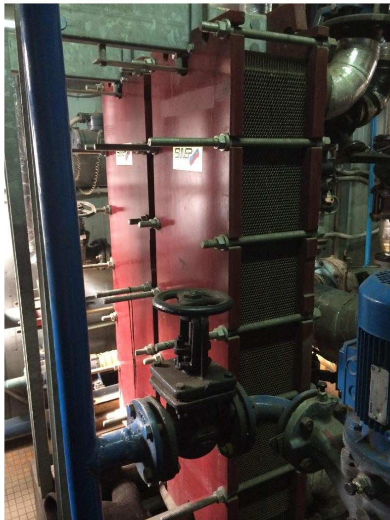
Рисунок 1.42 – Теплообменное оборудование котельной ЦРБ
