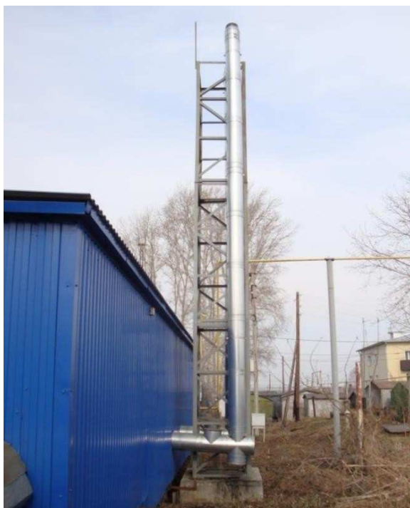
Рисунок 1.38 – Дымовые трубы котельной Ленинская
