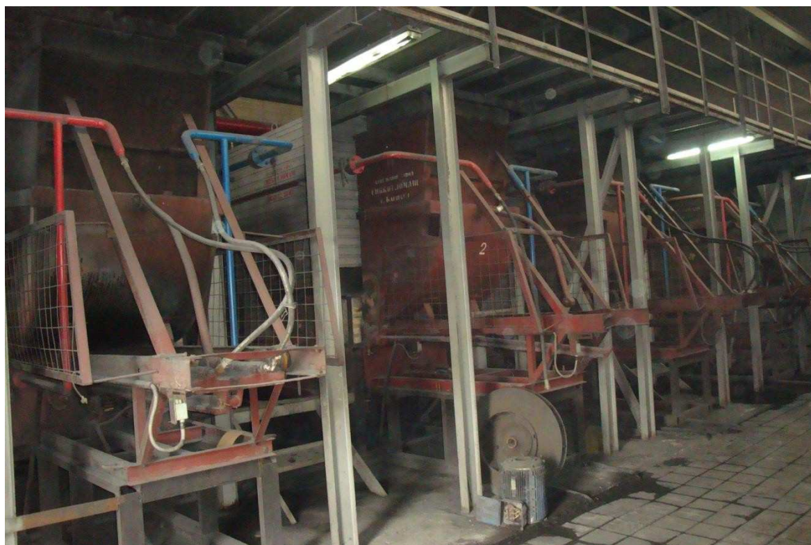
Рисунок 1.24 – Котельное оборудование котельной Коченевская
