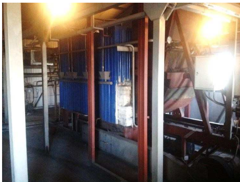
Рисунок 1.18. Котельное оборудование котельной РТП
