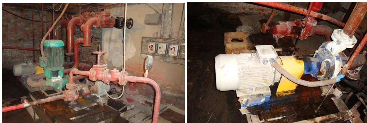
Рисунок 1.56 – Насосное оборудование котельной Восток
