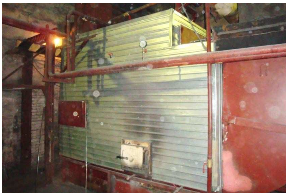
Рисунок 1.47 – Котельное оборудование котельной Ростелеком
