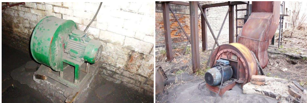
Рисунок 1.58 – Тягодутьевое оборудование котельной Восток
