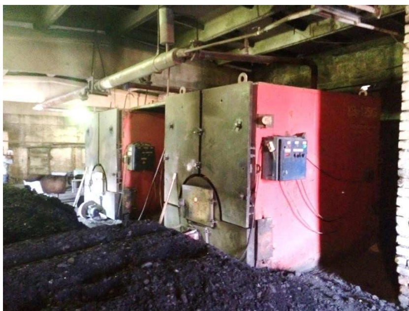
Рисунок 1.33 – Котельное оборудование котельной школы №13
