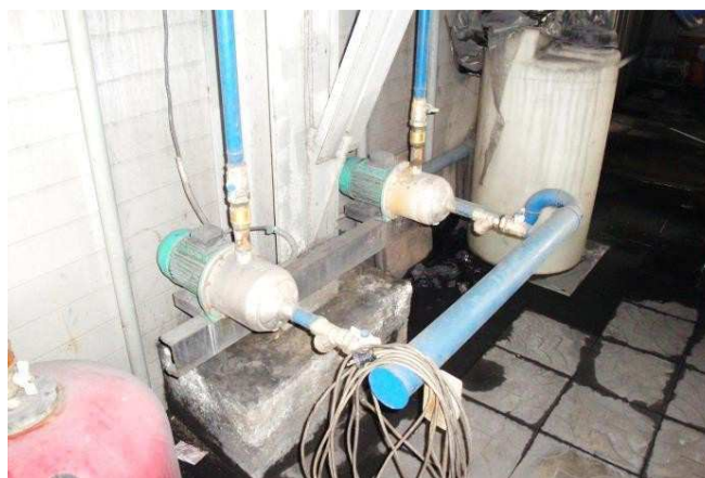
Рисунок 1.27 – Подпиточные насосы котельной Кочневская
