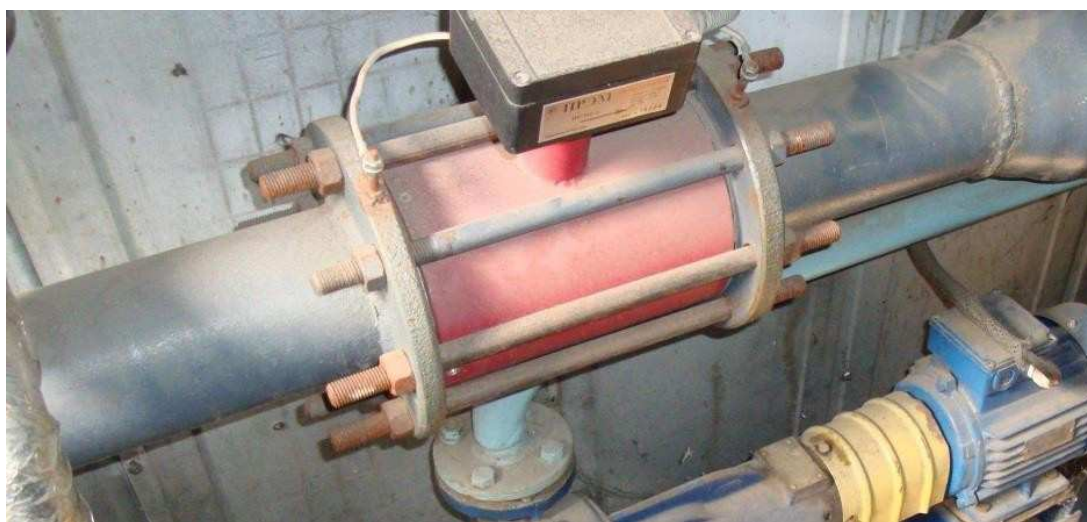
Рисунок 1.44 – Узел учета тепла котельной ЦРБ.
