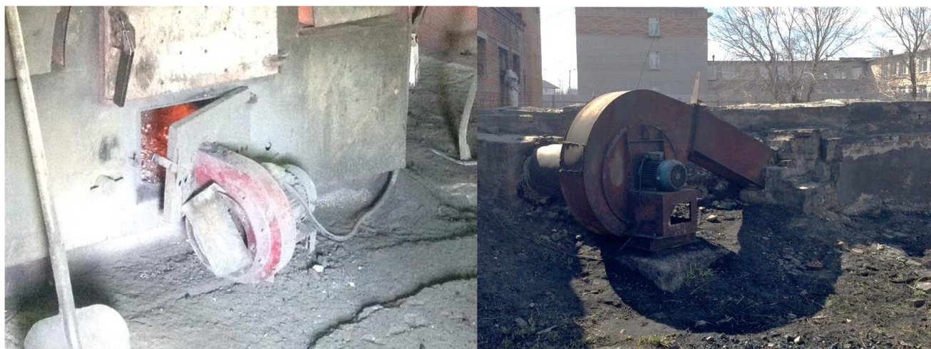
Рисунок 1.36 – Тягодутьевое оборудование котельной школы №13
