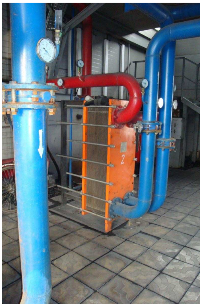
Рисунок 1.28 – Теплообменное оборудование котельной Кочневская
