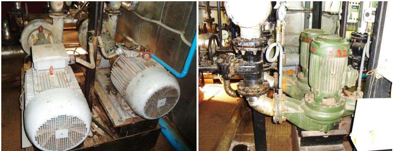
Рисунок 1.41 – Насосное оборудование котельной ЦРБ
