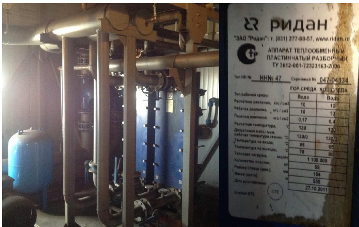
Рисунок 1.20 – Теплообменное оборудование котельной РТП
