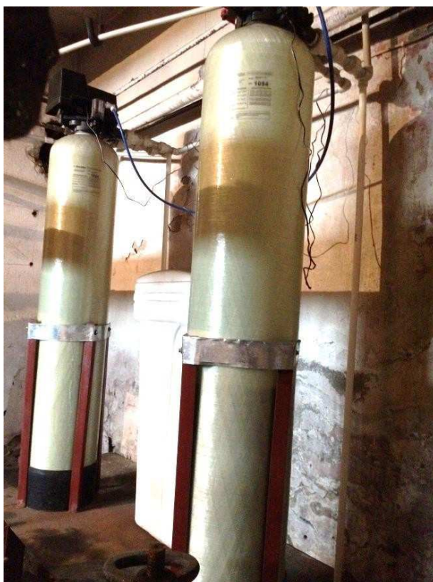
Рисунок 1.50 – Система водоподготовки котельной Ростелеком
