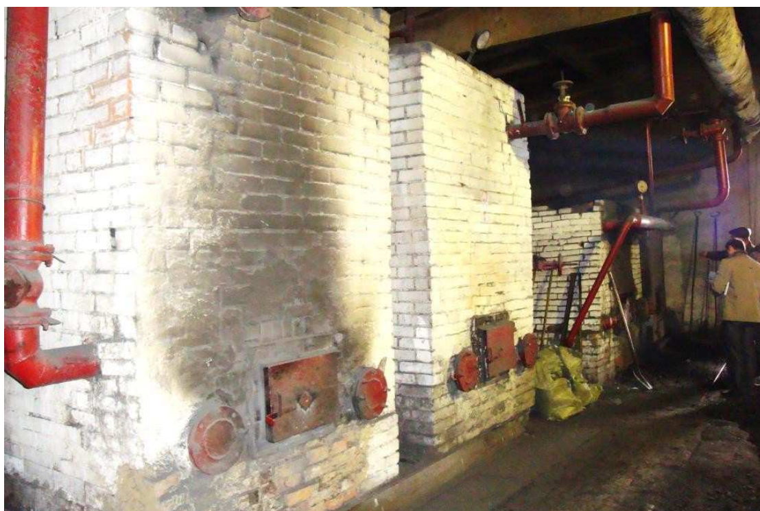
Рисунок 1.55 – Котельное оборудование котельной Восток
