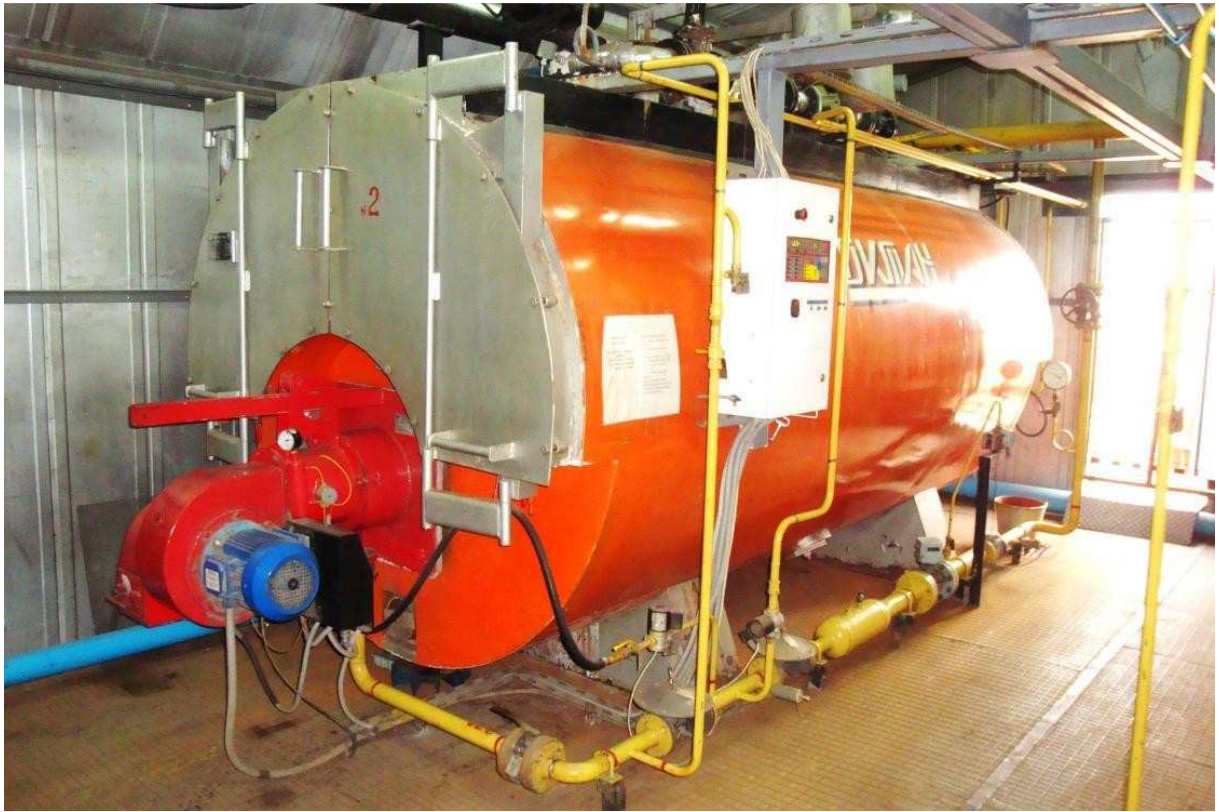
Рисунок 1.40 Котельное оборудование котельной ЦРБ
