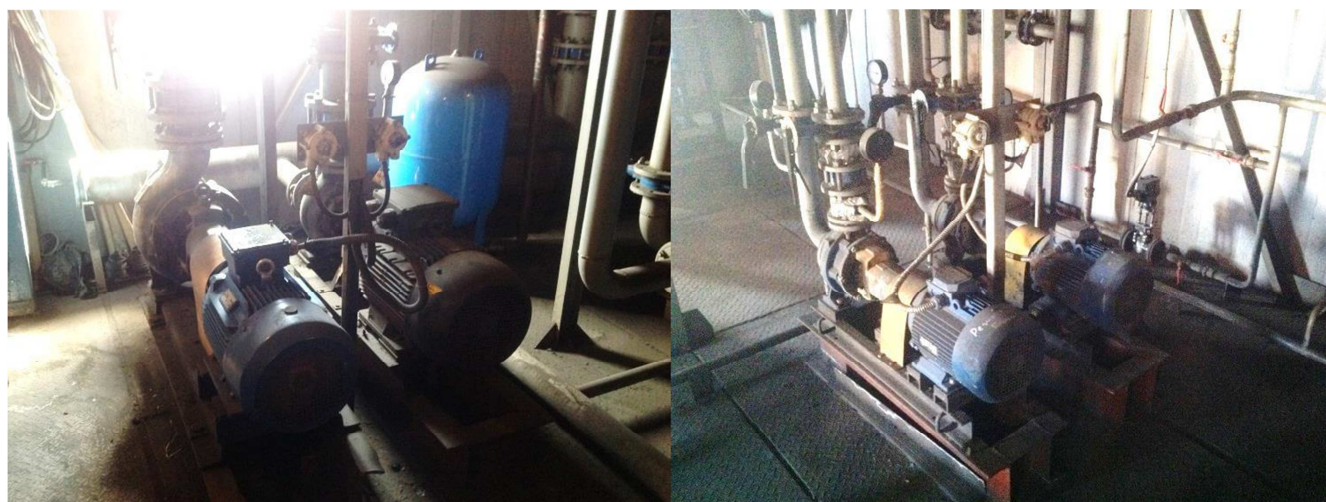
Рисунок 1.19 – Насосное оборудование котельной РТП
