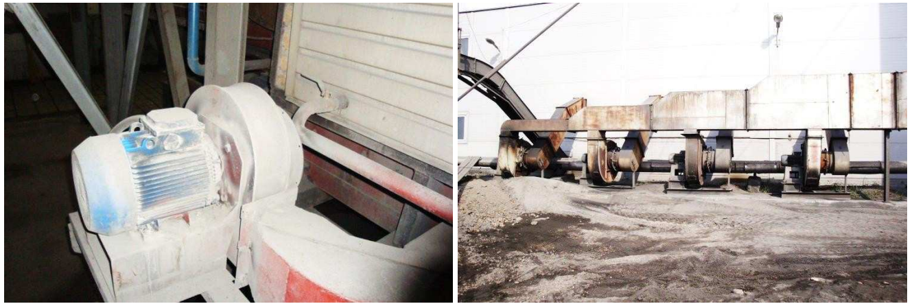
Рисунок 1.31 – Тягодутьевое оборудование котельной Коченевская
