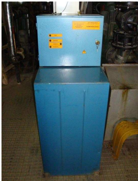
Рисунок 1.43 – Система водоподготовки котельной ЦРБ
