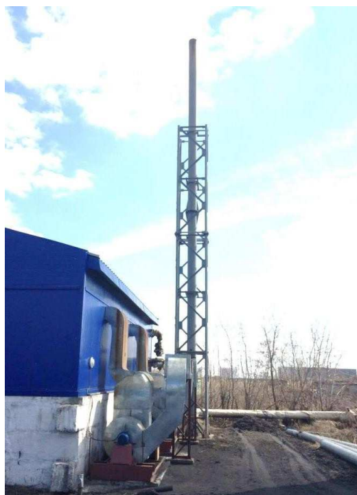
Рисунок 1.21 – Дымовая труба котельной РТП
